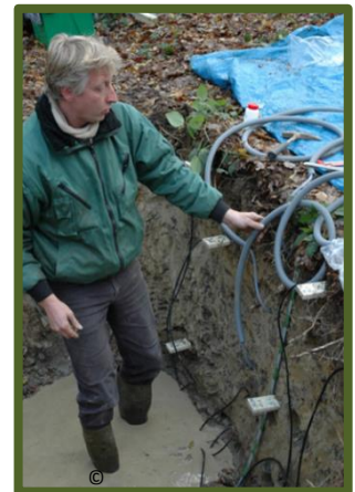
Fig. 7. Mise en place de sondes pour le suivi en continu de la réserve en eau dans le sol
